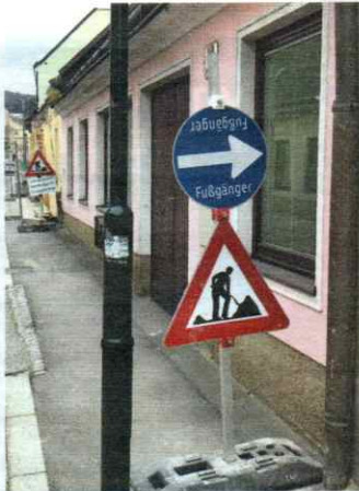
Baden bei Wien. Während der Bauarbeiten müssen Fußgänger durchs Fenster ausweichen. Foto: Maria Schuster.
